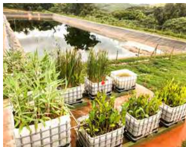
Sistema alagado construído (wetlands) para tratamento de chorume UVS Ecovia - Conselheiro Lafayete - MG
